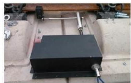
监测钢轨纵向位移的位移计
